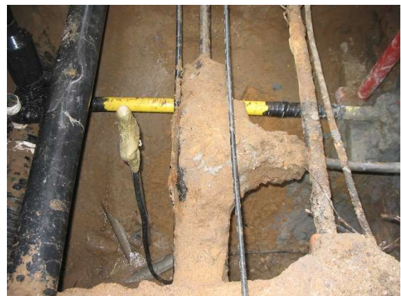
Bild 5: Metallene Installationen im Erdreich
